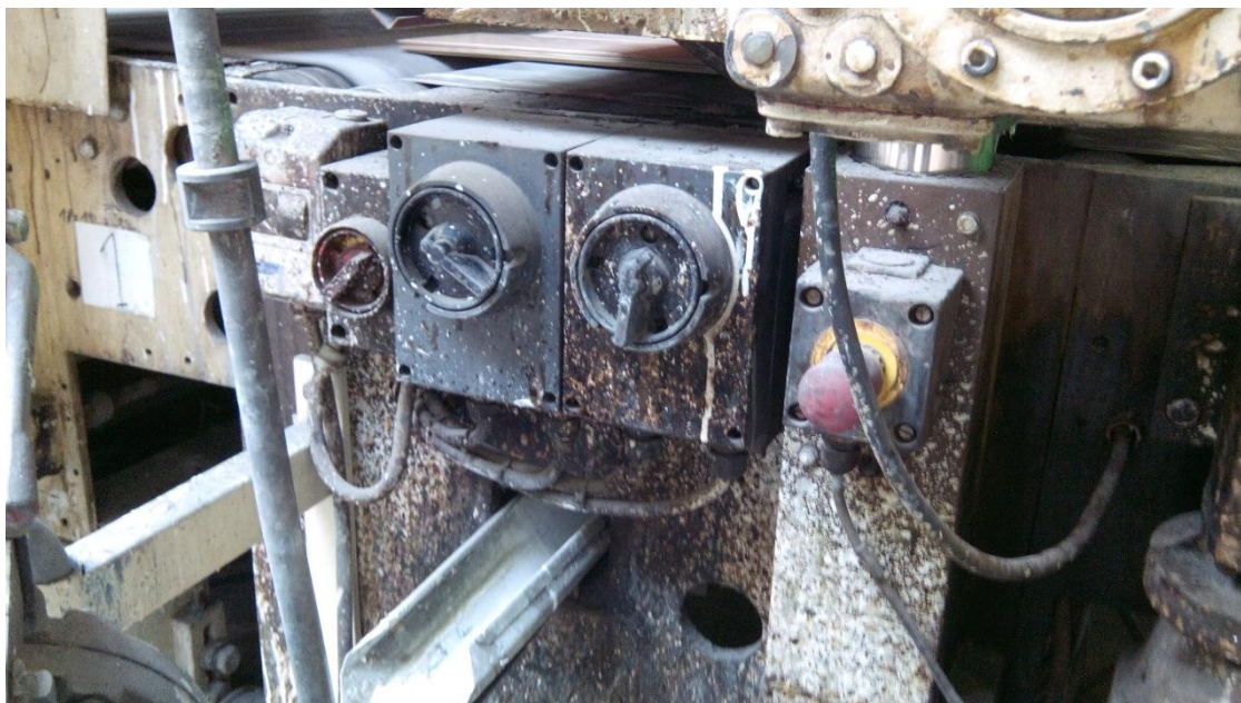
Figuur 22: bedieningsschakelaars van arbeidsmiddel 11
