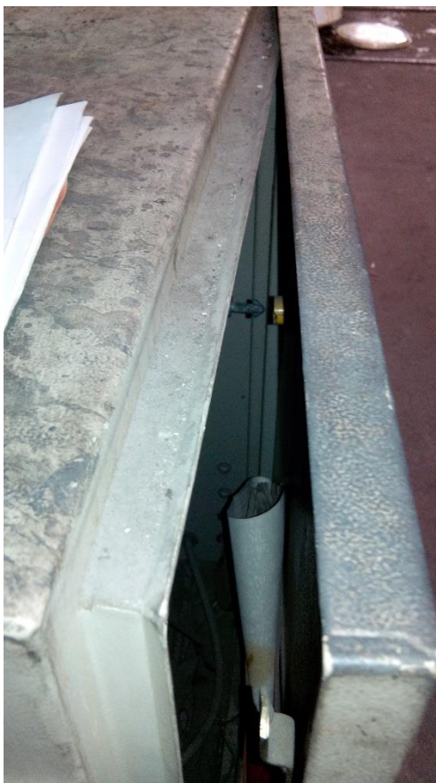
Figuur 26: Open spanningskast van arbeidsmiddel 14
