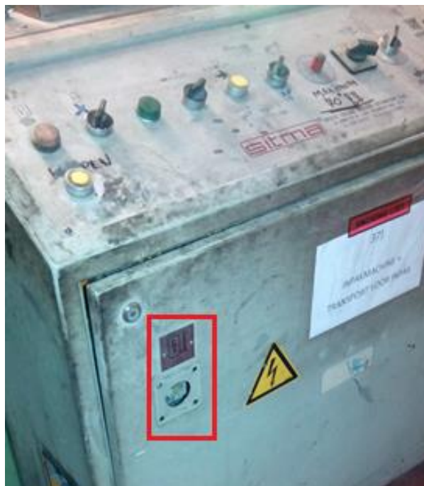
Figuur 43: Aanduiding hoofdschakelaar op het bedieningspaneel van arbeidsmiddel 26
