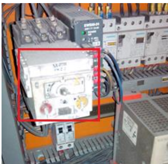
Figuur 44: Hoofdschakelaar van arbeidsmiddel 26
