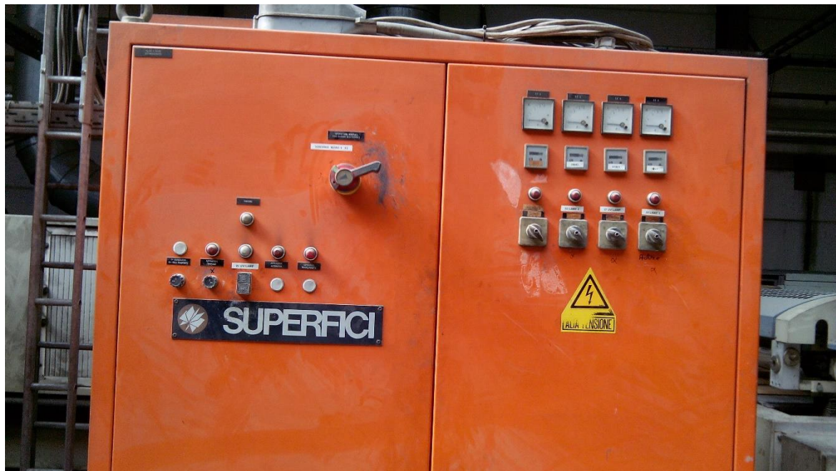
Figuur 27: Stroomkast van de 3 Superfici UV-machines.
