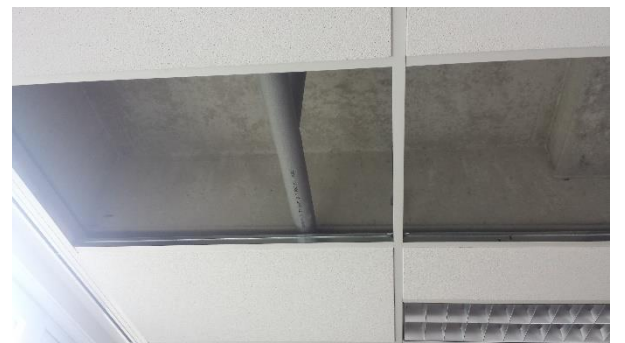
Figuur 29: Foto van verwarmingsbuis in vals plafond
