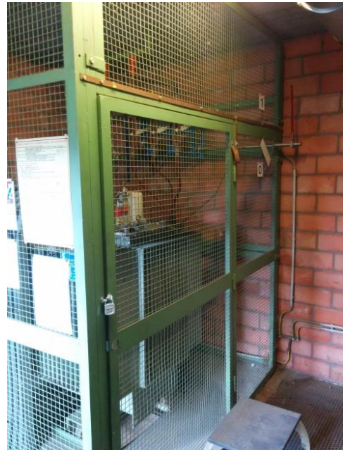
Figuur 14: foto transformatorcel zonder vonkspatplaten
