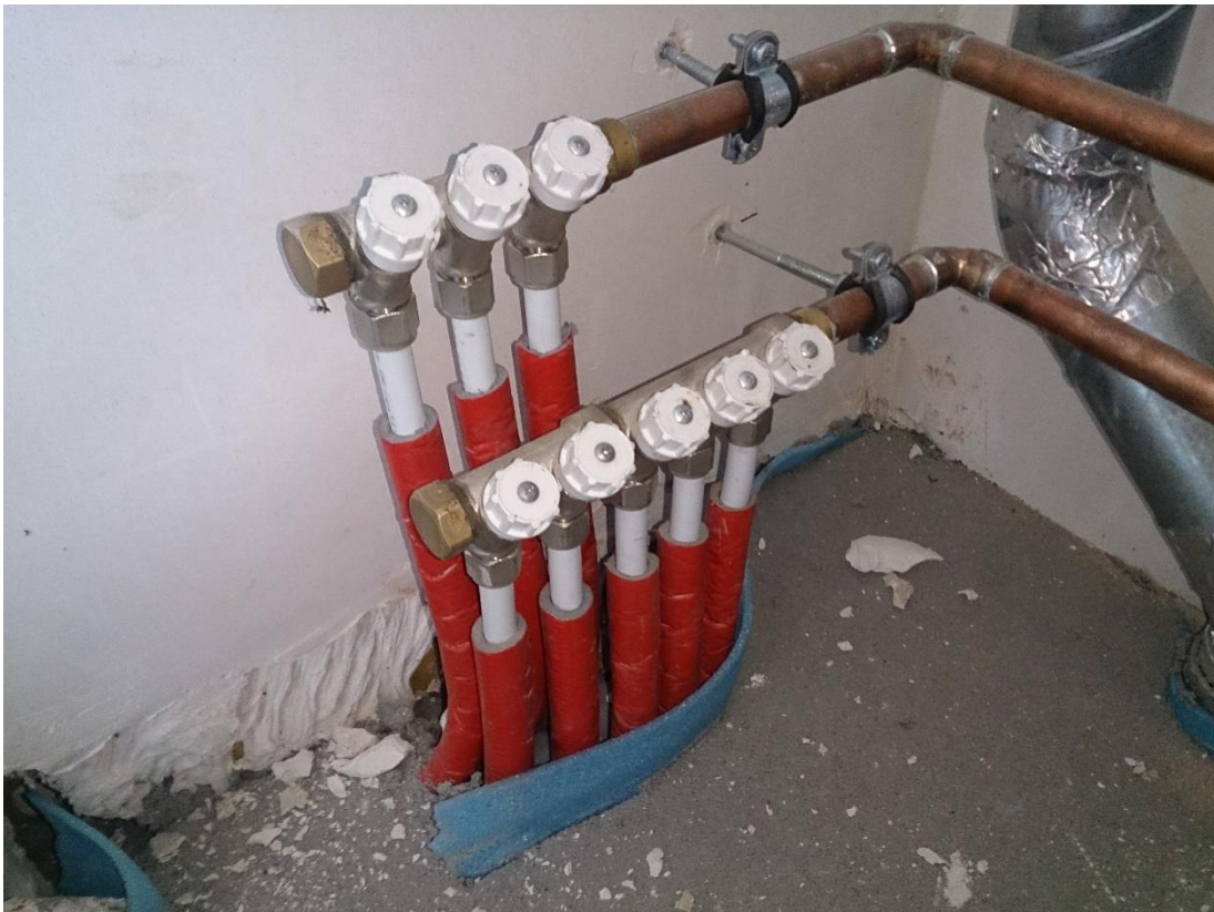
Figuur 18 Collectoren voor het sanitair water
