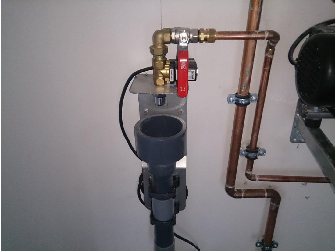
Figuur 20 Reservoir van het regenwatersysteem
