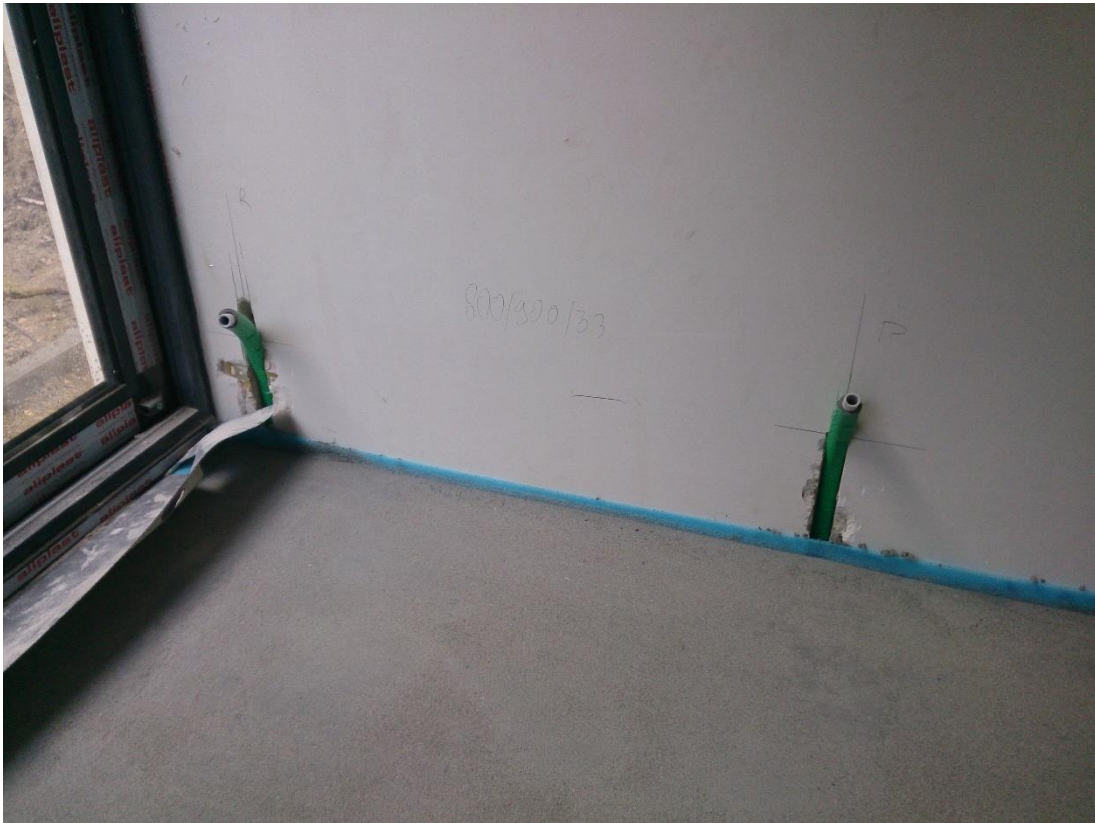
Figuur 16 Aan- en afvoerleiding van een radiator
