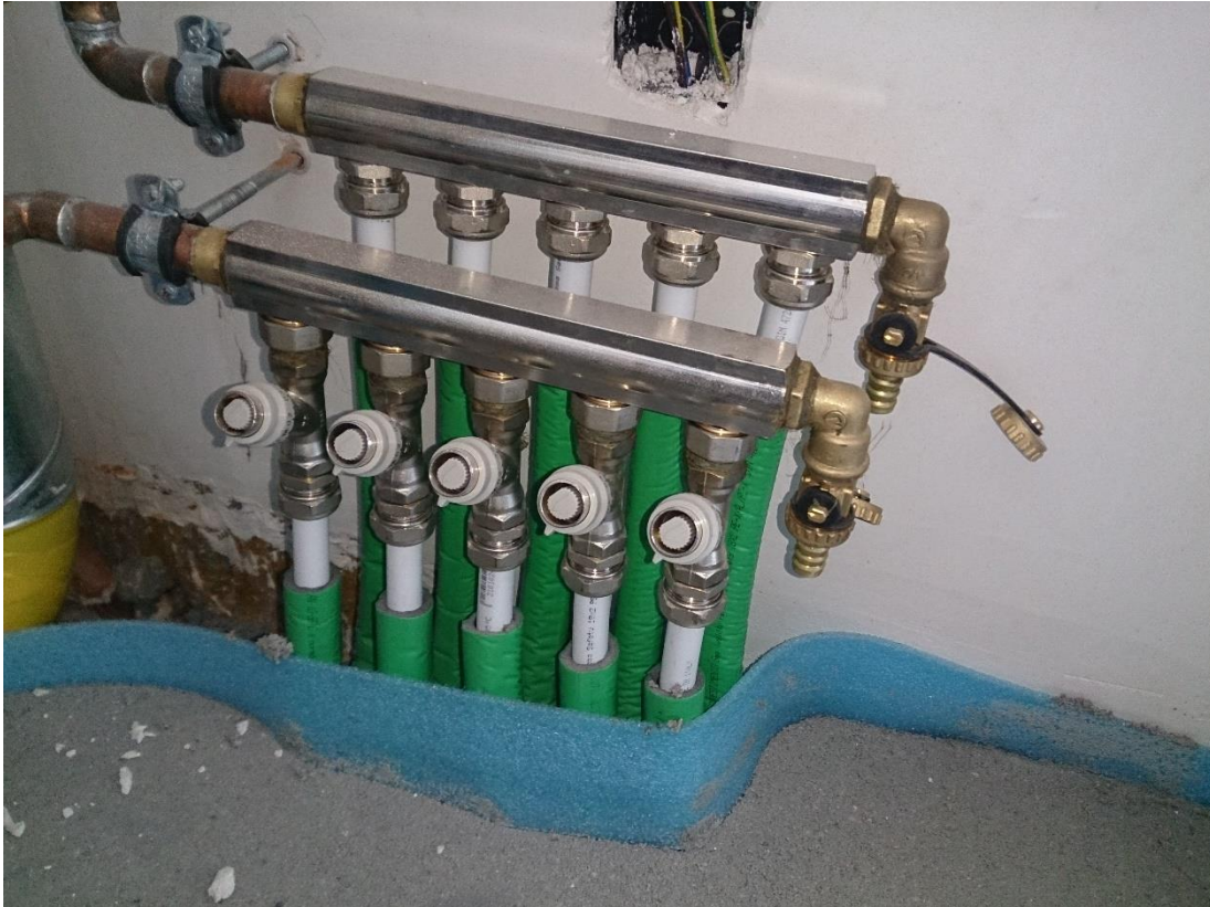
Figuur 17 Collectoren voor CV
