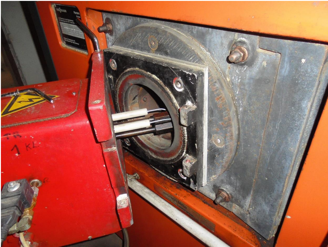
Figuur 25 Flens van een verwarmingsketel
