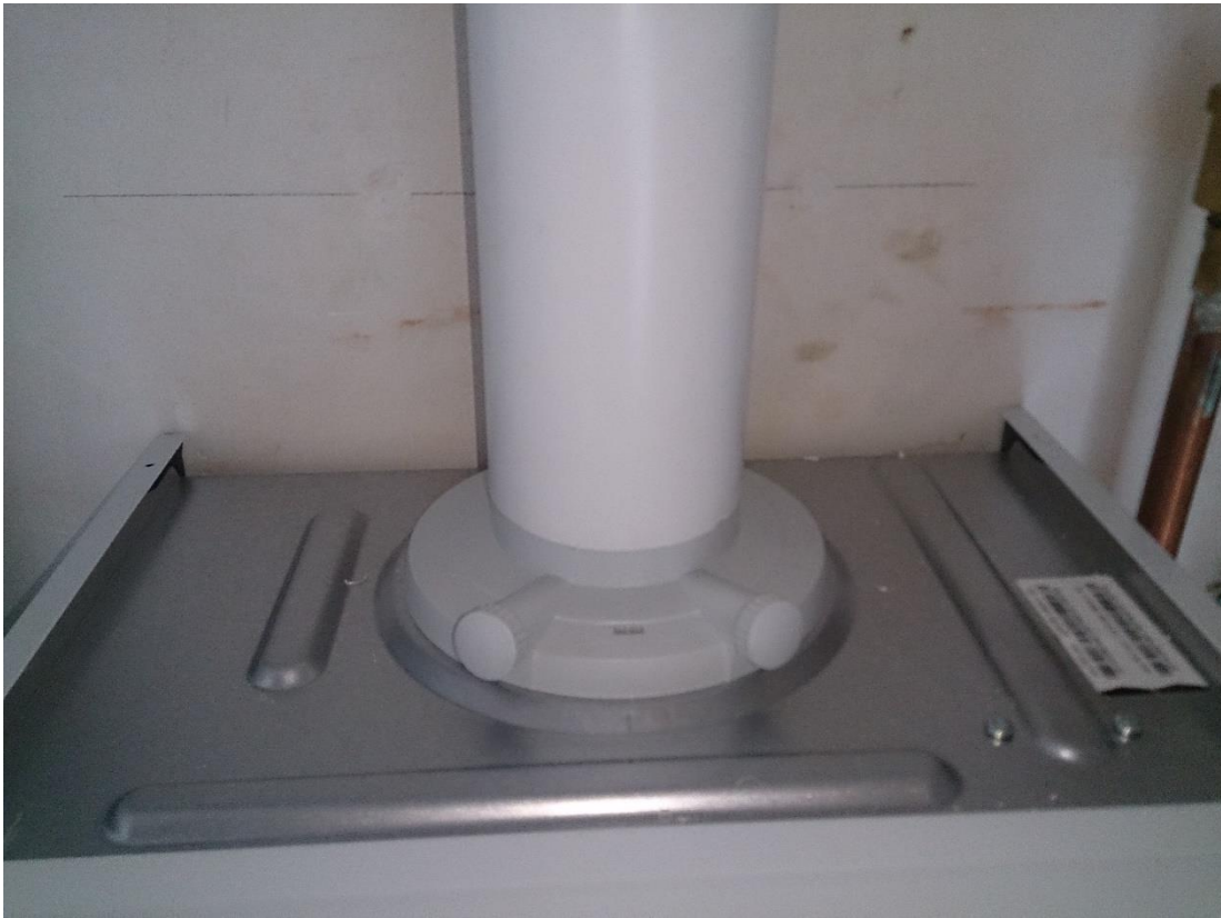
Figuur 6 Rookgasafvoer van de ketel
